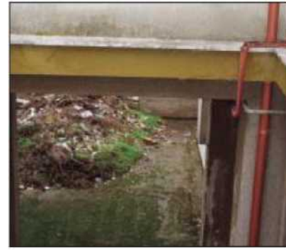
L'ospedale di Nicotera e alcuni particolari che rivelano l'attuale livello di degrado
