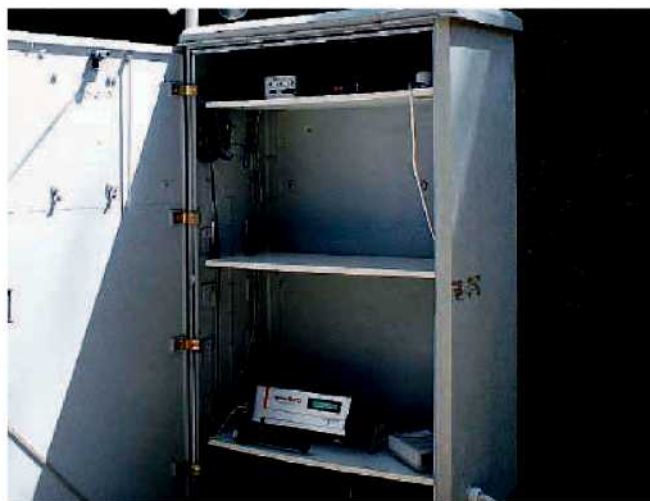
Una centralina per monitorare i gas radon
