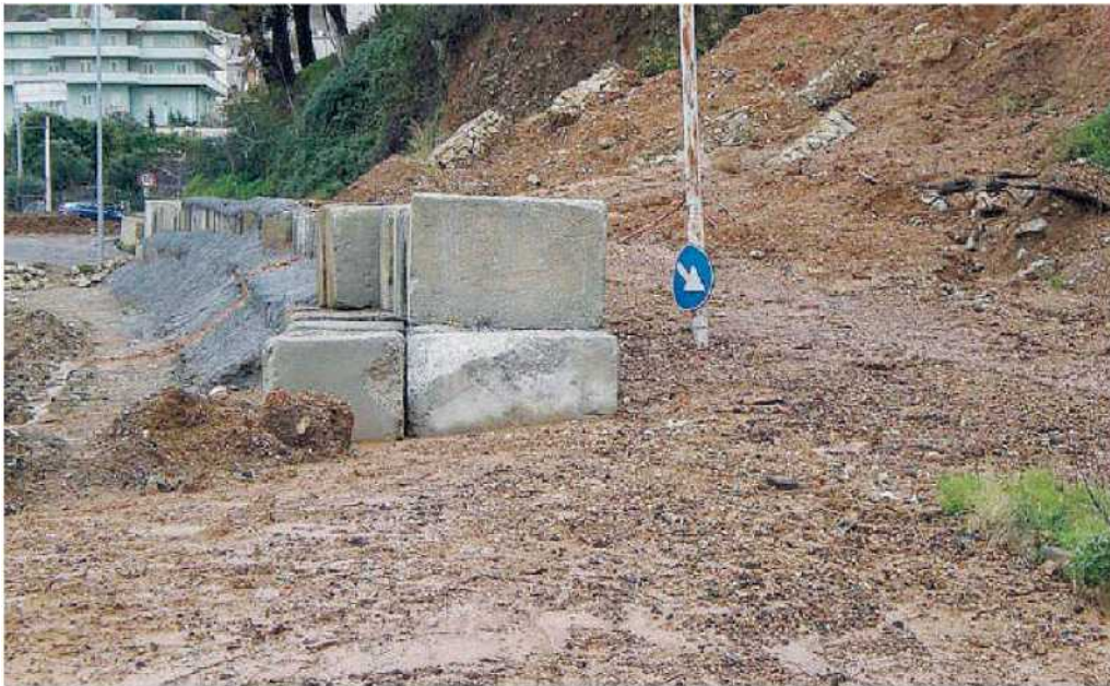
Il movimento franoso sta mettendo in serio pericolo la strada a valle dell'ospedale "San Francesco"
