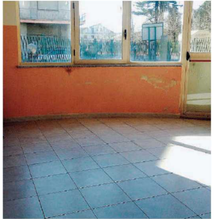
Incrostazioni alle pareti della struttura sanitaria
