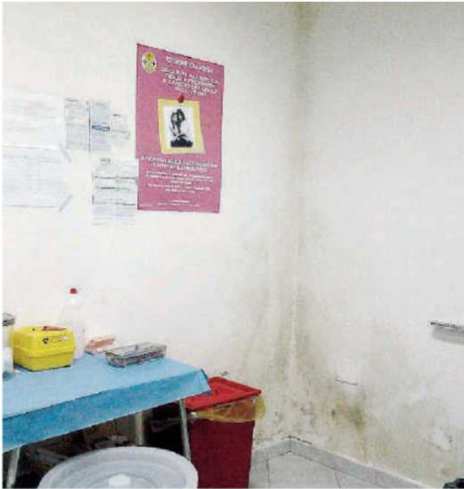
Vistose tracce di umidità all'interno dei locali
