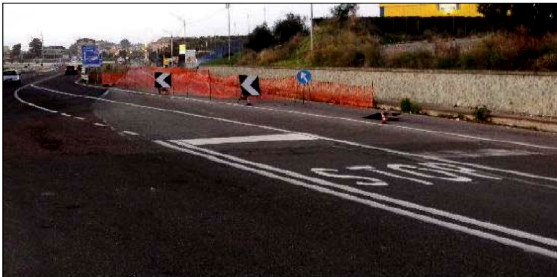
I punti sono nei quartieri Verghello e Lido compreso tra le vie Forni, viale Europa (in foto), via Lungomare e Melito Porto Salvo
