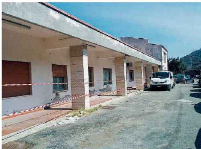
Il portico nel quale si è verificato il cedimento degli intonaci
