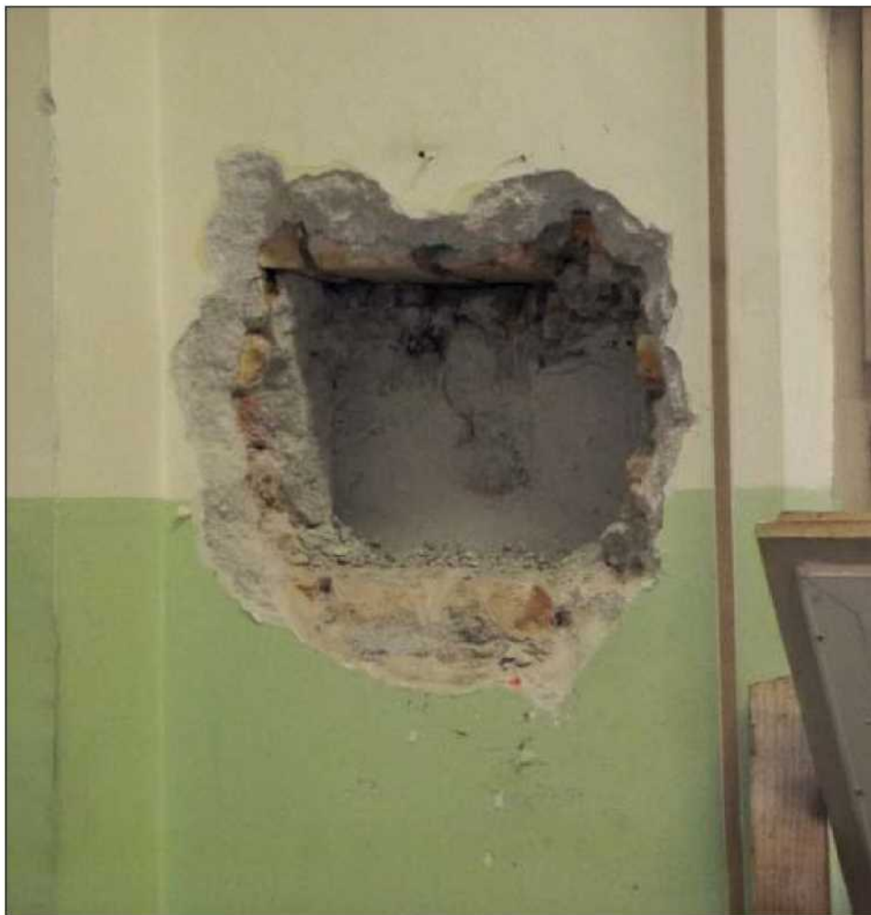
La parete del poliambulatorio presso cui era installata la cassaforte (foto Gaetano d'Urso)
