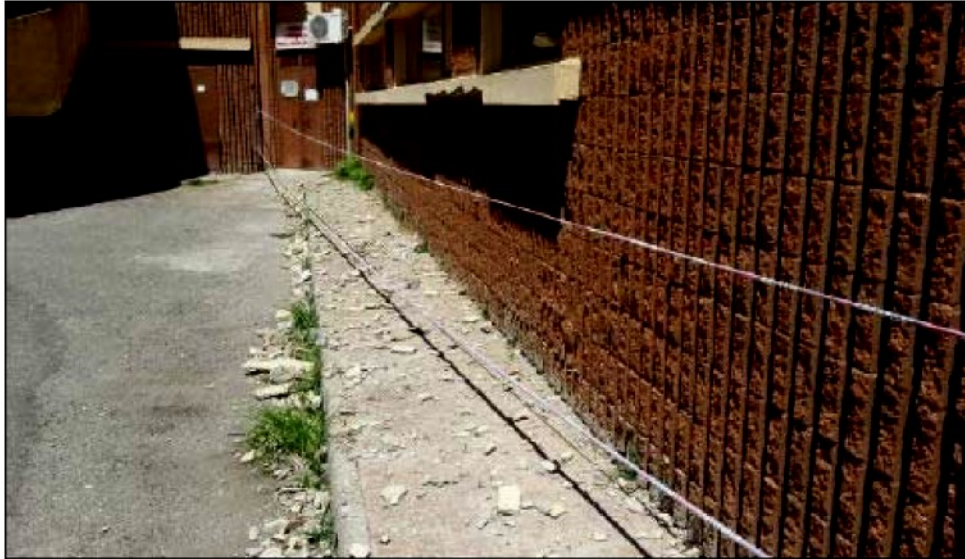
I calcinacci caduti dal tetto del poliambulatorio di Cirò Marina
