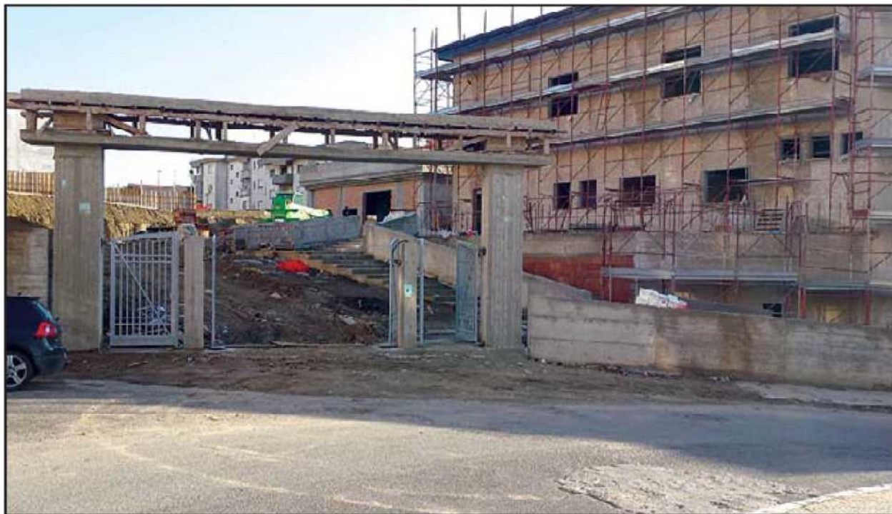
Nella foto sopra il cantiere del Polo oncologico del Marrelli Hospital. I lavori proseguono spediti in attesa dell'autorizzazione all'esercizio e dell'accreditamento
