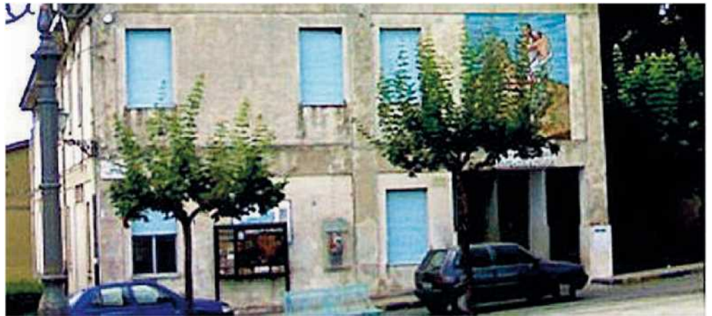
Presidio a forte rischio. L'edificio che ospita la struttura sanitaria di base: indispensabile intervenire in fretta
