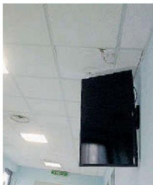
Schermo guasto. E gli utenti si sono affollati all'ingresso dell'ufficio
