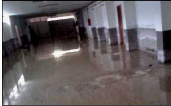
Allagamento all'edificio del "Santoni"
