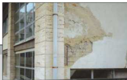
L'intonaco si stacca
