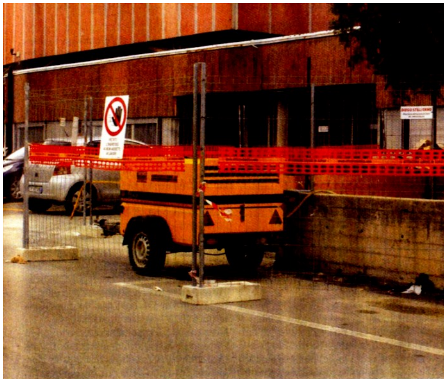
Il cantiere dell'ospedale "Bianchi-Melacrino-Morelli" di Reggio. Sotto, la delibera con la quale l'Asl concede una proroga alla ditta Busi. Nella pagina successiva, calcinacci e rifiuti lasciati all'esterno della struttura come in una discarica a cielo aperto
