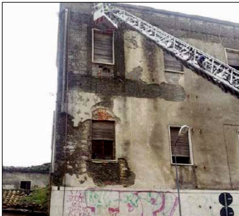
L'intervento dei vigili del fuoco per mettere in sicurezza l'area
